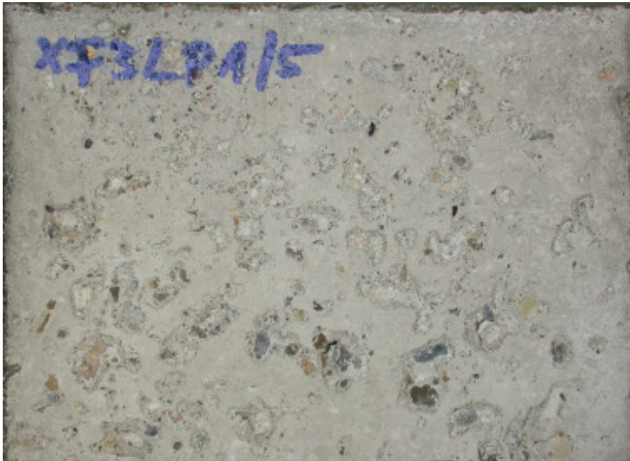
Bild 28: Foto der Prüffläche der Laborprobe XF3LP-1/5 nach 56 Frost-Tau-Wechseln der CIF-Prüfung (Abwitterungsgrad: 0,6).
