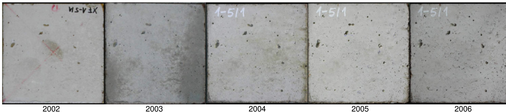
Bild 57: Bildserie der Prüffläche des Probekörpers XF1-5/1 nach der Herstellung (2002) und im Frühjahr der Jahre 2003 bis 2006.
