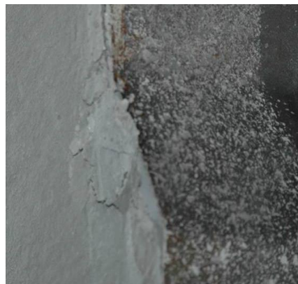
Bild 6.48: Oberflächliche Betonabplatzung (5) im Bereich der Kantung
