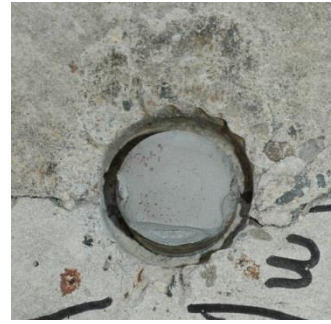
Bild 4.15: Sehr geringe Betonzerstörung am Beispiel von Körper QE3/8 - Betonseite
