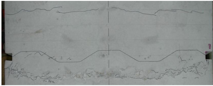
Bild 6.174: Versagen der Betondruckzone auf der Oberseite von Körper R-Q3
