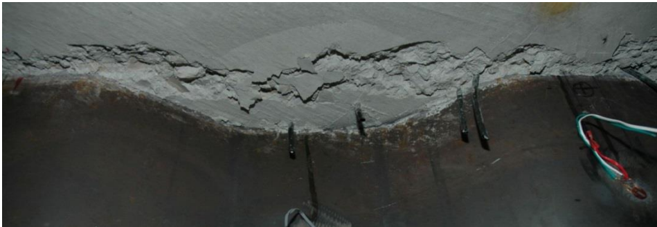
Bild 6.175: Betonausbruch auf der lastzugewandten Seite des Betongurts an Körper R-Q3
