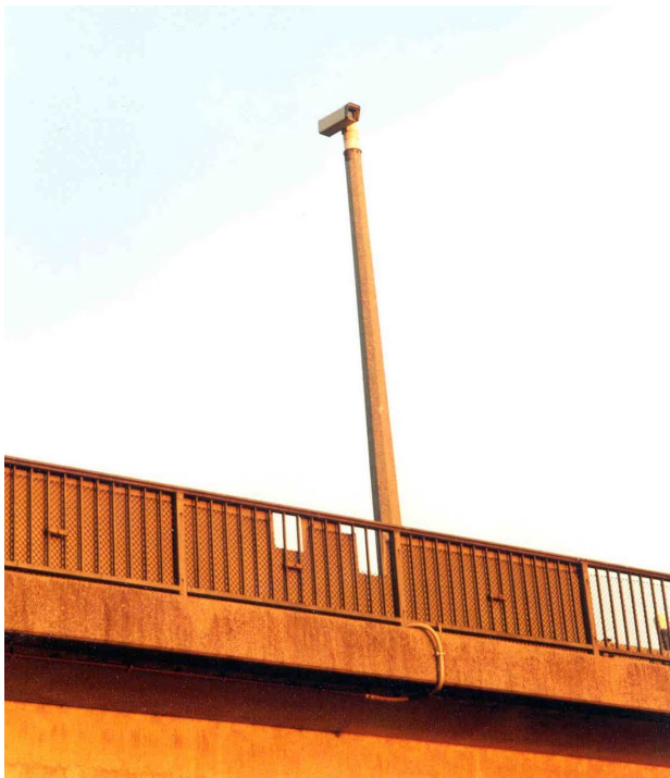
Abbildung A.4: Überwachungskamera an der Brücke der St 2341 über die A 92
