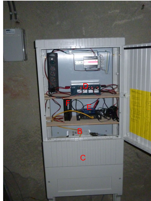
(b) Schaltschrank SNS2.
