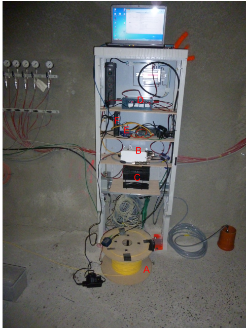
(a) Schaltschrank SNS1.
