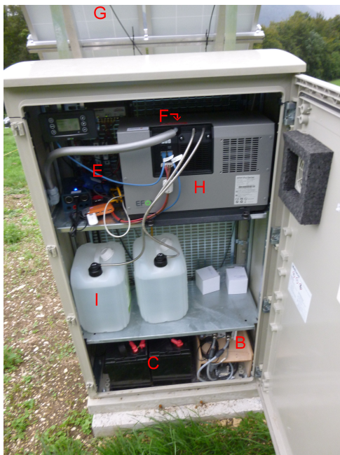
(c) Schaltschrank SNS3 mit Solarpaneelen im Hintergrund (G) und Brennstoffzelle (H) sowie Methanoltanks (I) zusätzlich.
