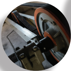
Lift technology: traction drive Aufzugstechnik: Treibscheibe
