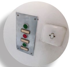
Exterior blinds control and light switch Raffstore- und Lichtschalter
