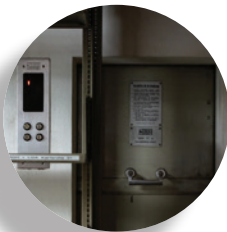
Freight lift Lastenaufzug
