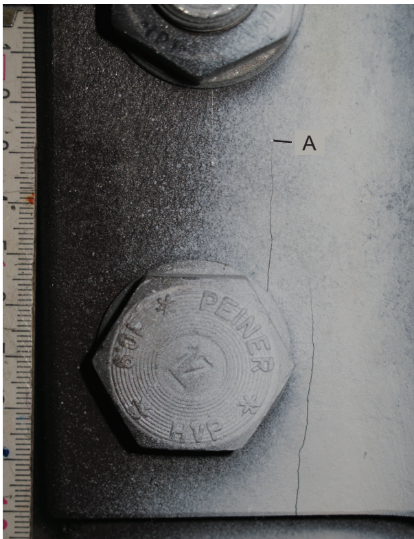
Abb. 10.12: Ermüdungsrisse an den seitlichen Winkeln des Prüfkörpers T2C.01
