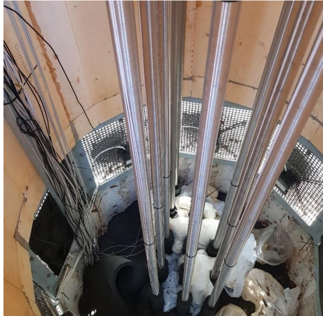
Abbildung 4.43: Foto im unteren Ende des Kaminaufbaus mit 3x3 Thermosiphon-Rohrbündel und Lufteinlass durch Lüftungsgitter und Ventilatoren
