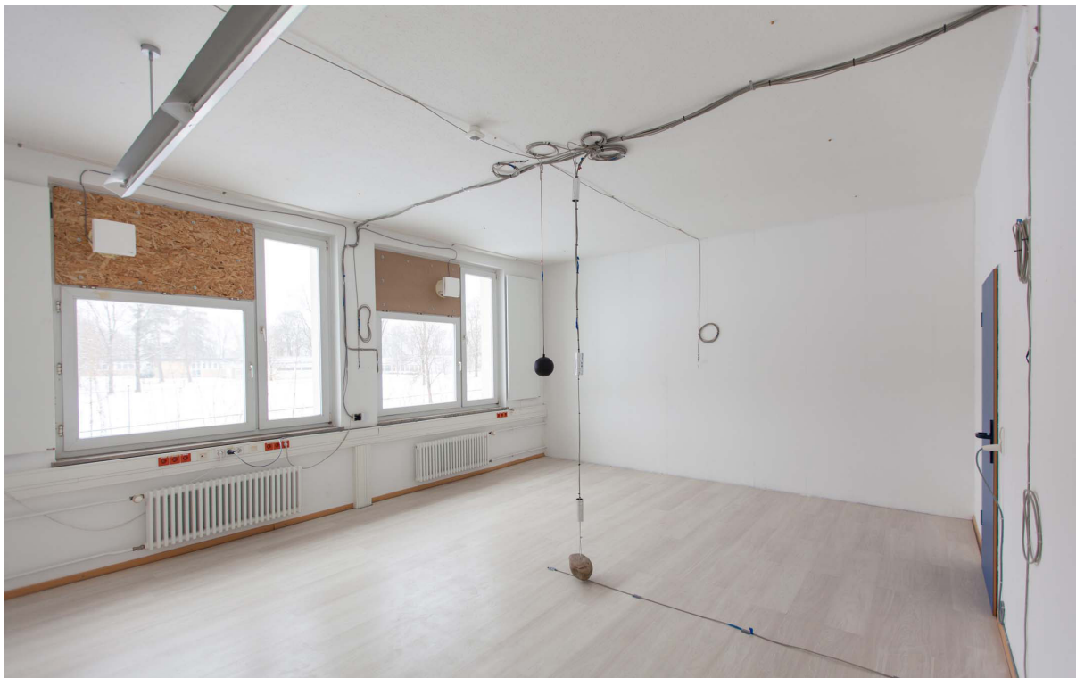
Abb. 15 Laborraum T4 mit IR-Heizung an der Wand
