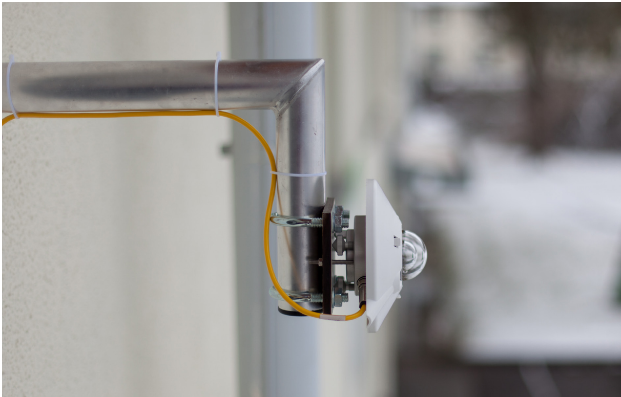
Abb. 34 Pyranometer SMP 10-A von Kipp und Zohnen in Fensterebene der Laborräume
