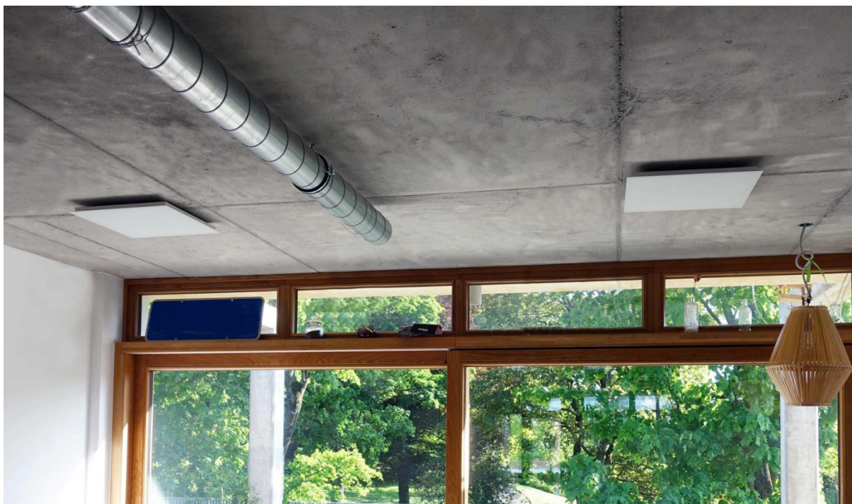
Abb. 4 Infrartheizungen K76 links und rechts sowie Lüftungsleitung
