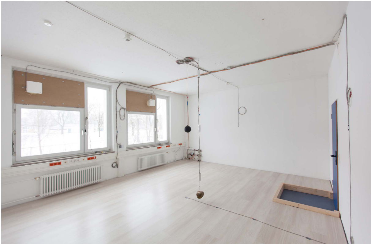
Abb. 9 Laborraum T1 mit wassergeführter Fußbodenheizung
