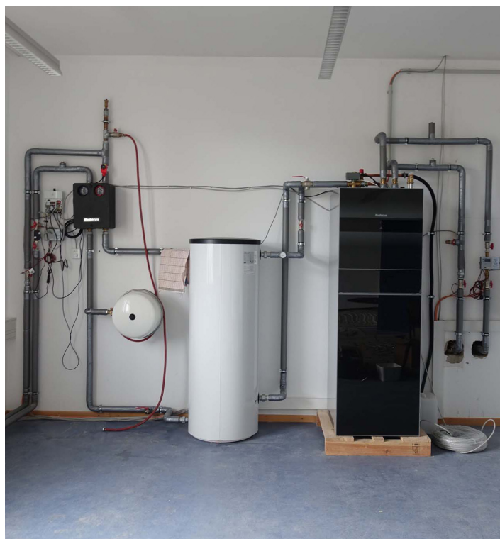
Abb. 12 Technikraum für Wärmepumpe mit Pufferspeicher
