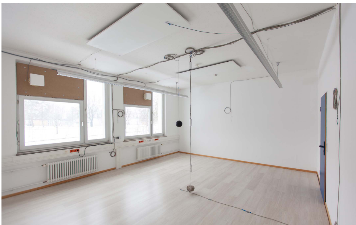
Abb. 14 Laborraum T3 mit IR-Heizung an der Decke
