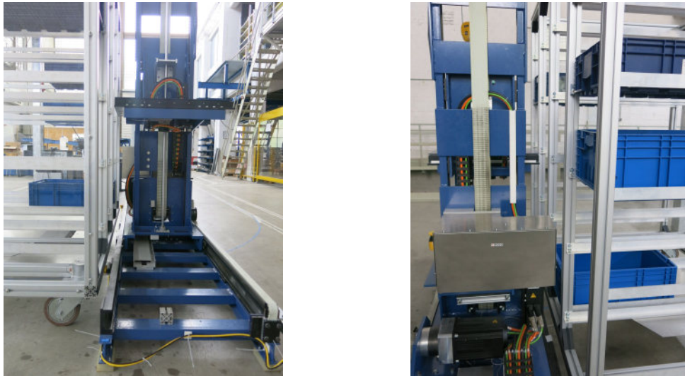
Abbildung 8.9: Mechanische Gefährdung durch Relativbewegung zwischen Regalbediengerät und den an das Maschinenbett angrenzend befindlichen Regalmodulen.
