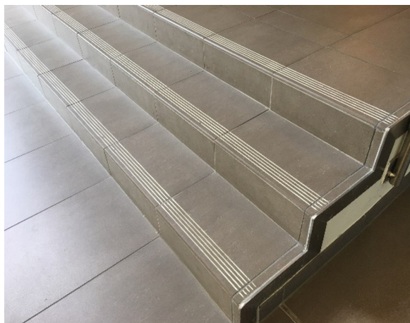
(b) Dreistufige steinerne Treppe im selber Ausführung wie 5-stufige Treppe in Unterabschnitt 7.5.3
