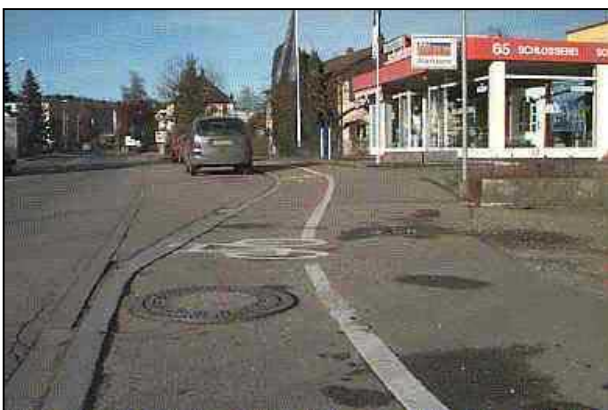
Abbildung 25: Kanaldeckel in Radfahrstreifen (Sicherheitsrisiko)
