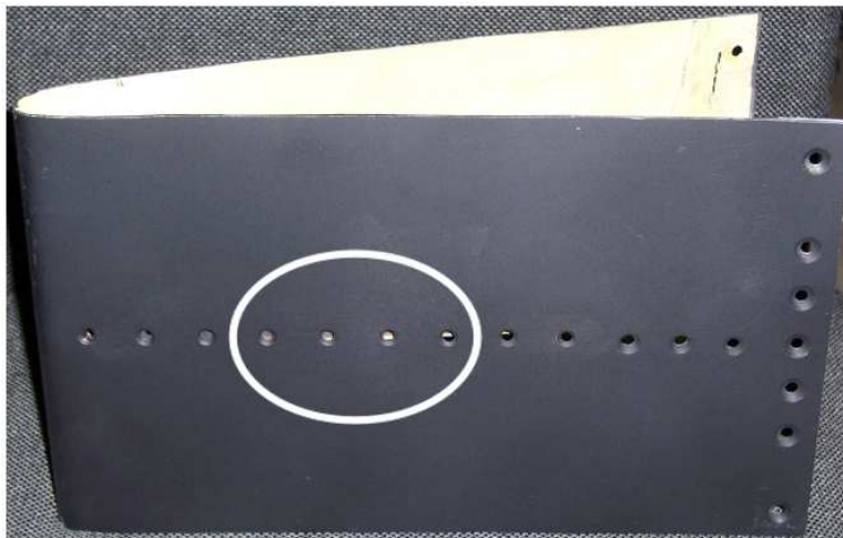
Abbildung 5.4: Ausschnitt aus Aluminium-Flugzeugbauteil mit Ermüdungsrisse zwischen Nietlochbohrungen (im Bereich der weißen Ellipse).
