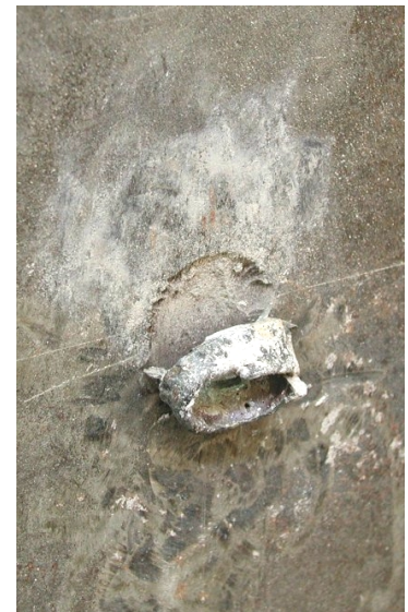
Bild 8-9. Anriß zwischen Schweißwulst und Baustahl – Versagenstyp B
