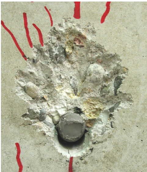
Bild 8-7. Lokales Betonzerbröseln auf der lastzugewandten Seite
