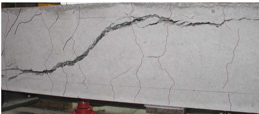
Bild 5.6: Foto von Plattenstreifen B3 nach dem Querkraftversagen a/d = 5
