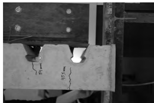
Betonausbruch V12-Co-1u Seite 2
