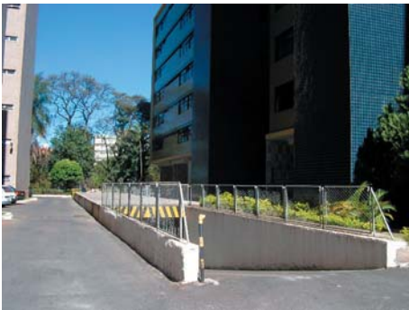
Abb. II.15: Nachträglich gebaute Tiefgarage _ nicht nach Norm, Block „H“, SQS 103. Quelle: Verfasser, 2003.
