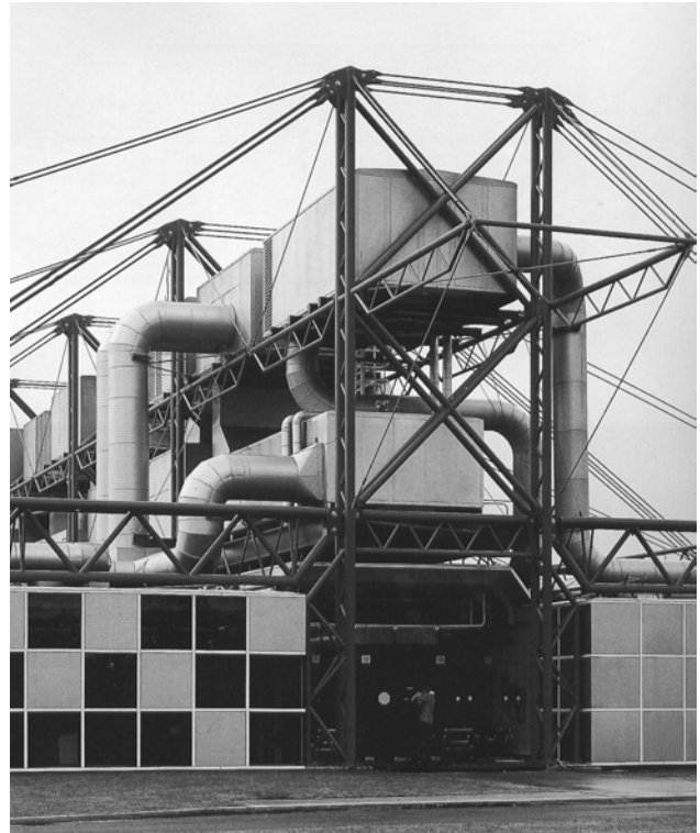
Abb. 4.20: Zwei Geschosse mit Installationsboxen
