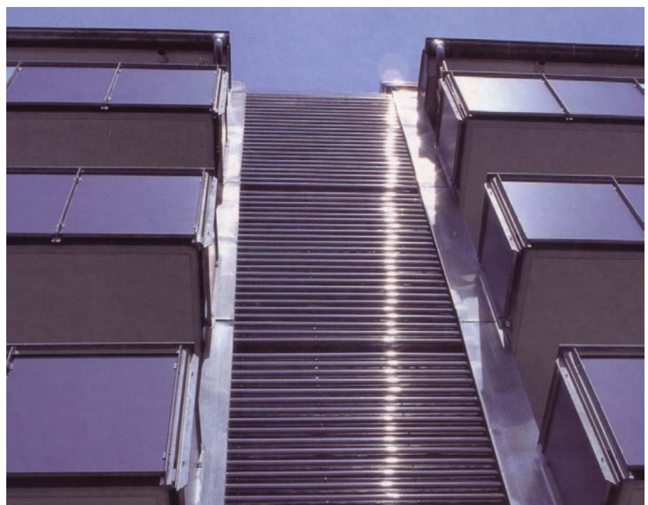
Abb. 9.09 Treppenhaus mit davor montierten Röhrenkollektoren
