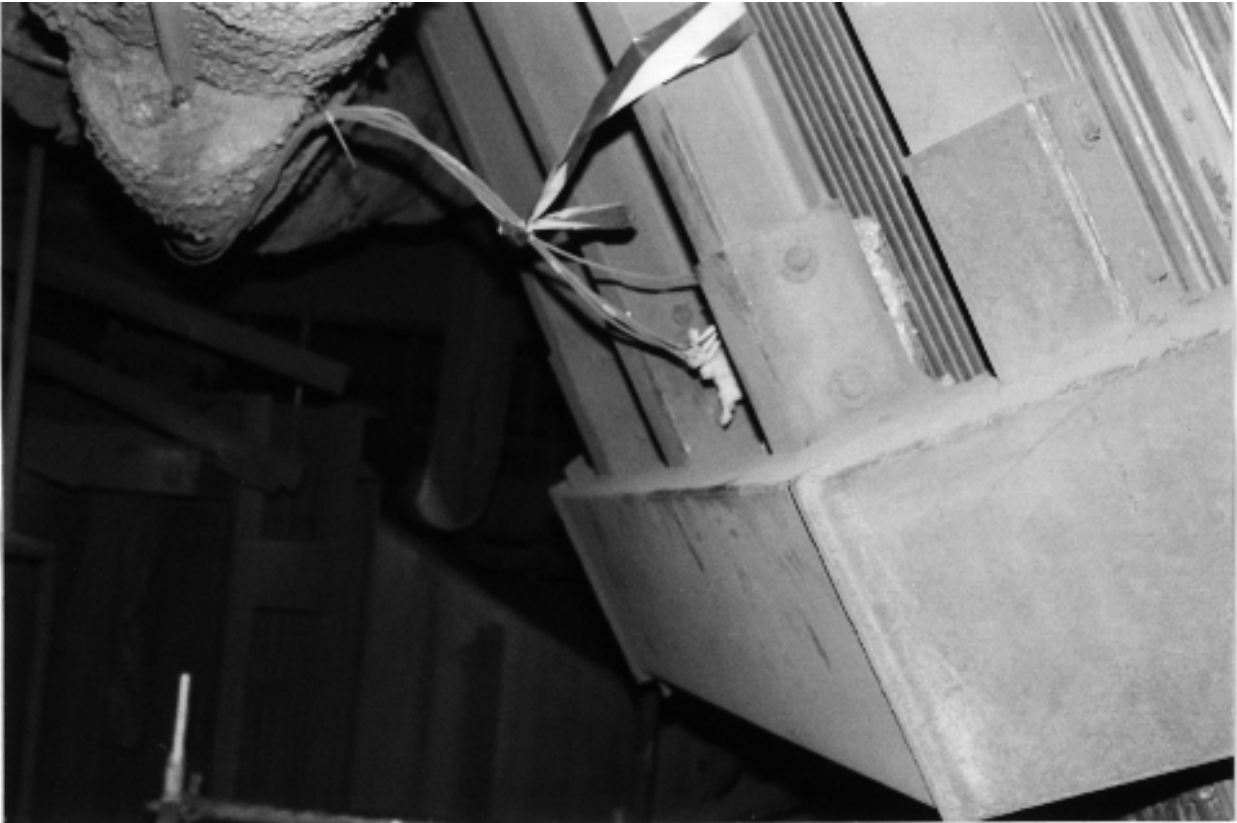
Abbildung 7-1: Verkabelung der Rückwand
