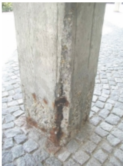
Abb. 1: Korrodierender Stützenfuß mit Betonabplatzung.
