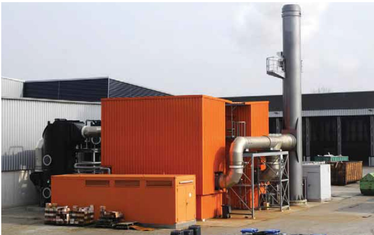
Abbildung 17: RTO-Anlage (orange) mit vorgeschalteten sauren Wäschern (schwarz) der MBA Großfehn [MKW GmbH & Co. KG 2013]
