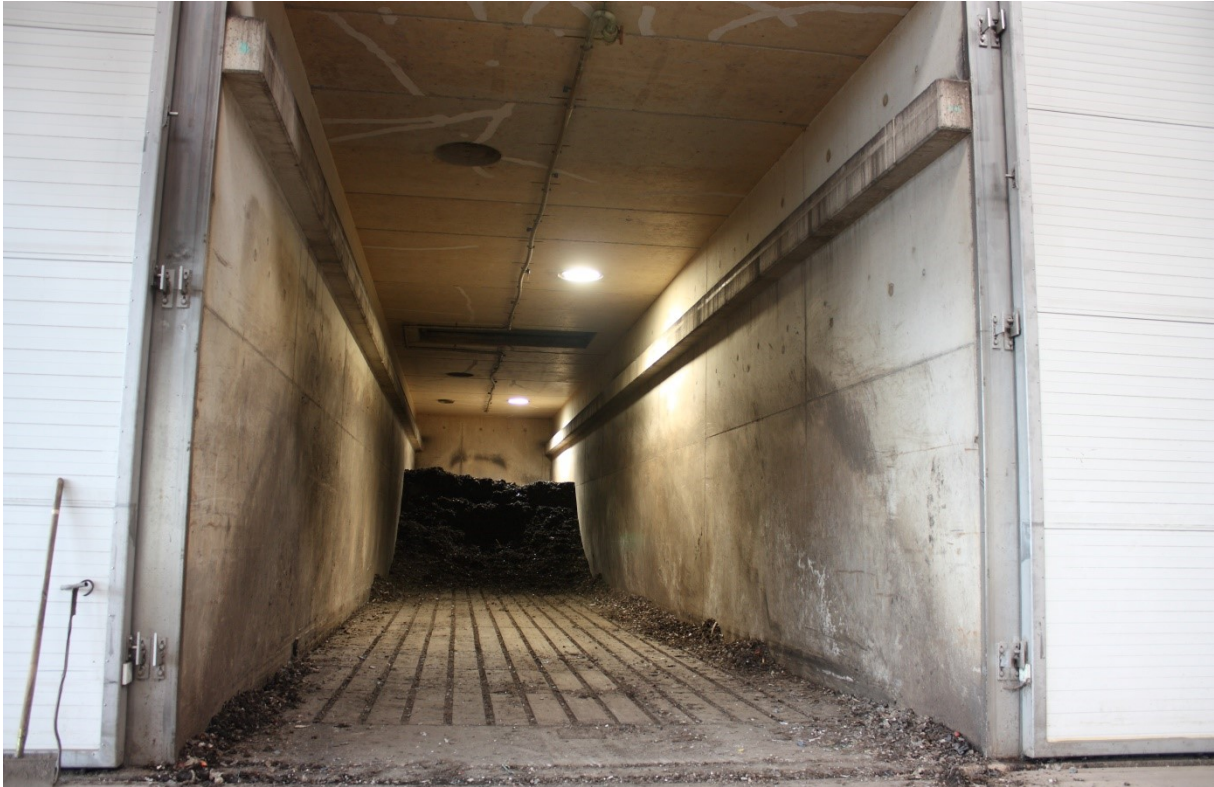
Abbildung 9: Blick in einen Rottetunnel der MBA Großefehn [Foto: Martin Kieninger 2013]
