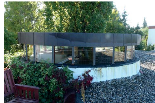
Dachterrasse, die Glaskuppel über dem Badezimmerturm wurde bei einem Hagelunwetter zerstört und vom Bauherrn durch einen Oberlichtkranz ersetzt
