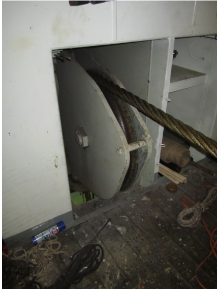
Abb. 84: Vertikal gelenkig gelagerte Seilscheibe der Schleppwinde aus Abb. 85
