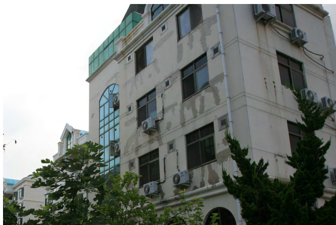
Abb.155. Bauqualität der Außenwände und Reparaturspuren
