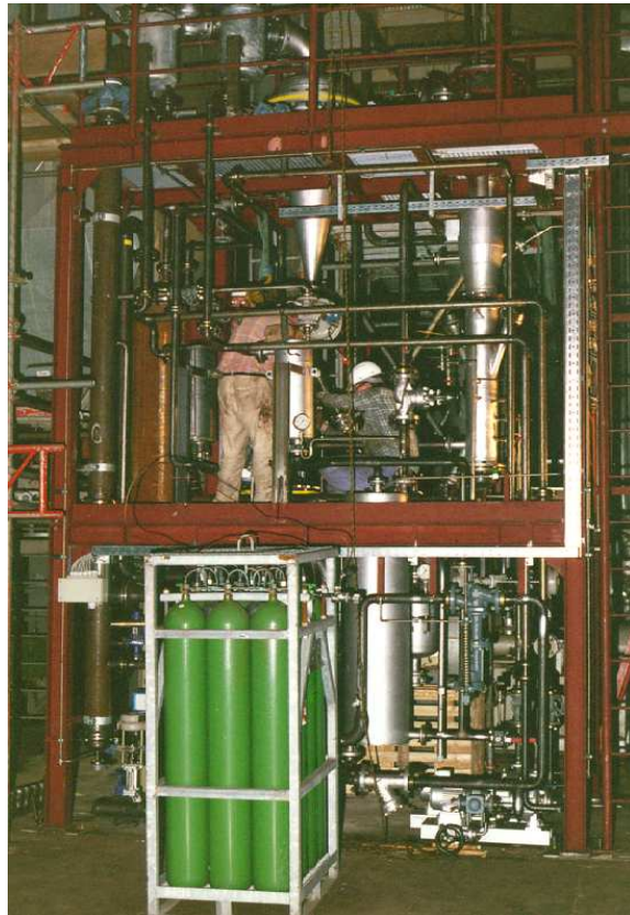
Abb. 5.4: Ansicht der Wirbelschicht-Versuchsanlage
