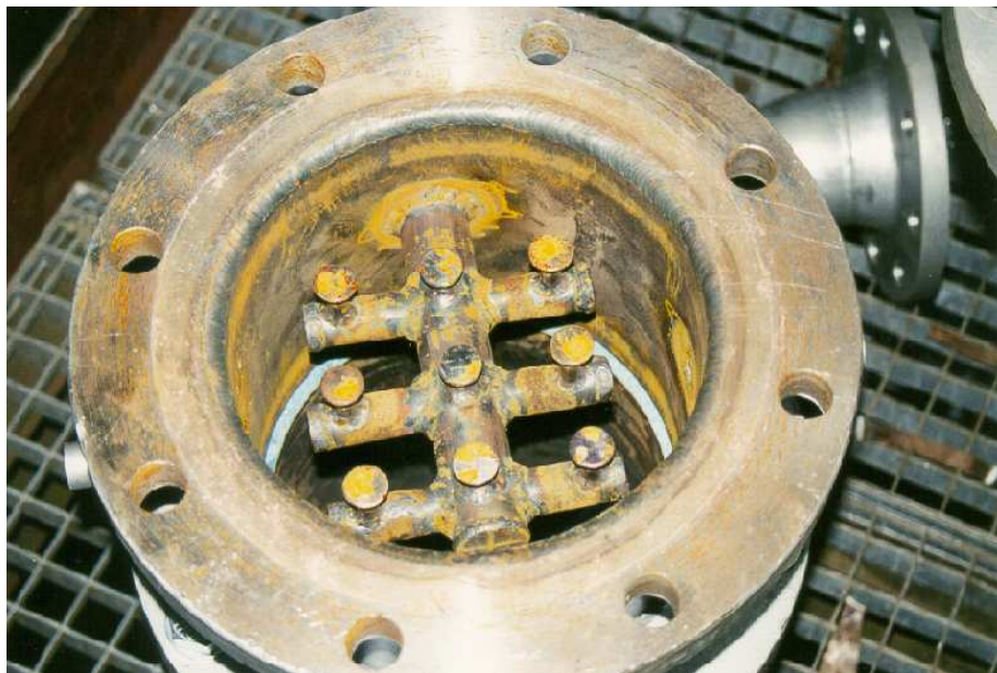
Abb. 5.8: Anströmboden in der Wirbelschichtversuchsanlage
