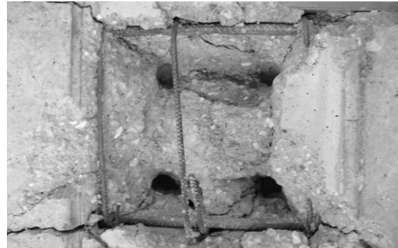
Bild 2-12: Betonausbruch zwischen der Rückhängebewehrung im Zugbereich nach Kuhlmann, Rybinski (2007)
