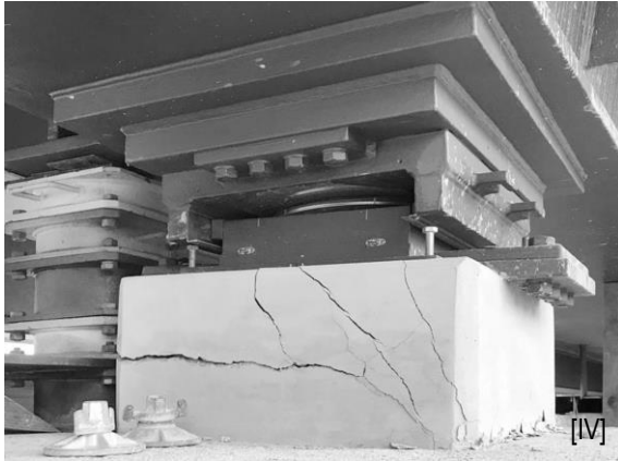
Bild 5-2: Schadensfall an einem Lagersatz durch hohe Querkraftbeanspruchung
