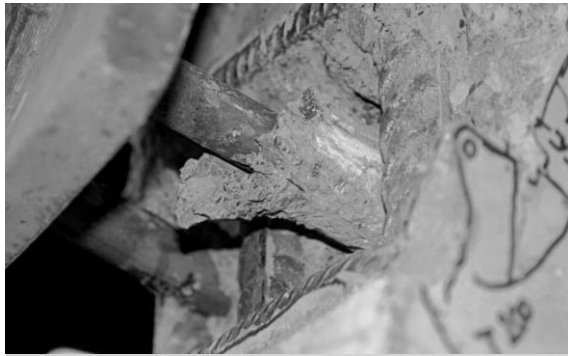
Bild 2-14: Betonausbruch zwischen der Rückhängebewehrung nach Fromknecht (2010)
